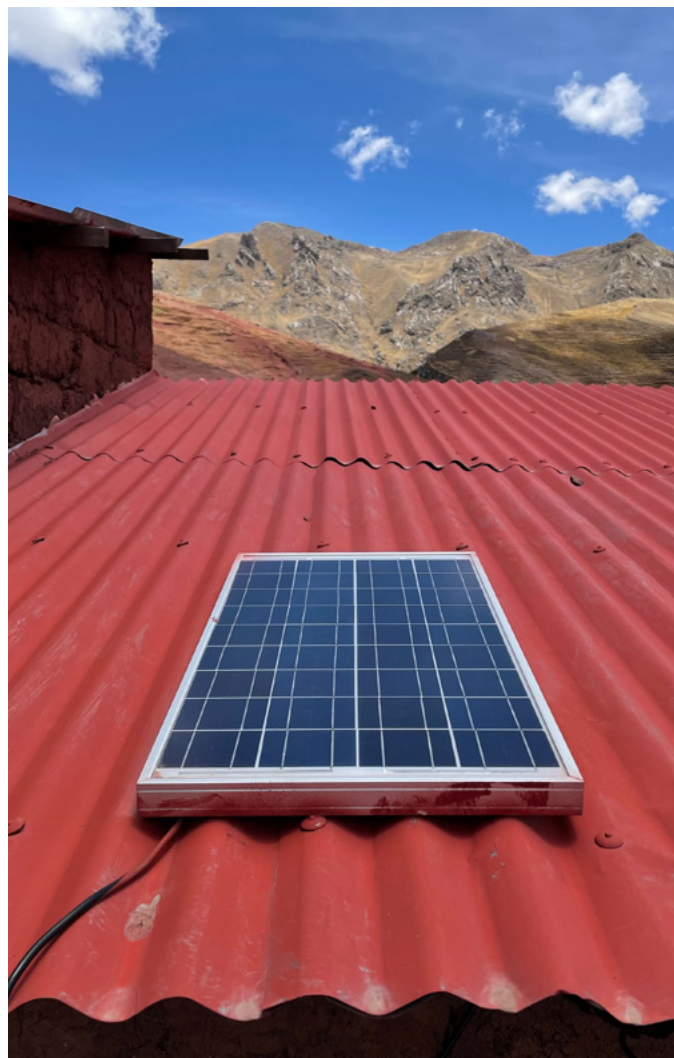
Photo: Panneau solaire installé sur le toit rouge d'une maison dans les montagnes du Pérou. © Flavio Ferraz F
